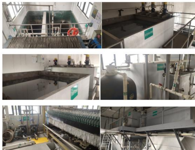
废水回收系统分别包括污泥池、反应槽、废液处理槽、PH 调整槽、斜管沉淀槽等
